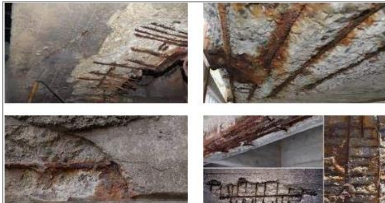
Şekil 1. Betonarme İçindeki Donatı Korozyonu
